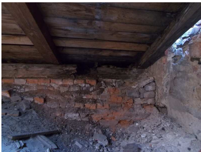
Příloha 20 Pultová střecha na severní straně – destrukce pozednice
