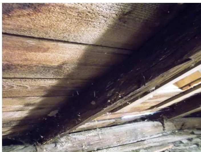
Příloha 18 Pultová střecha na jižní straně – krokev napadená houbou hnědého tlení
