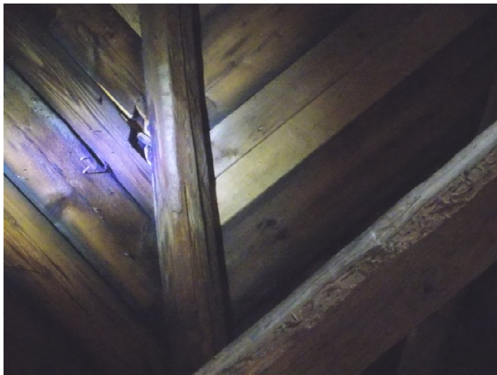
Příloha 14 Jižní věž – poškozené bednění
