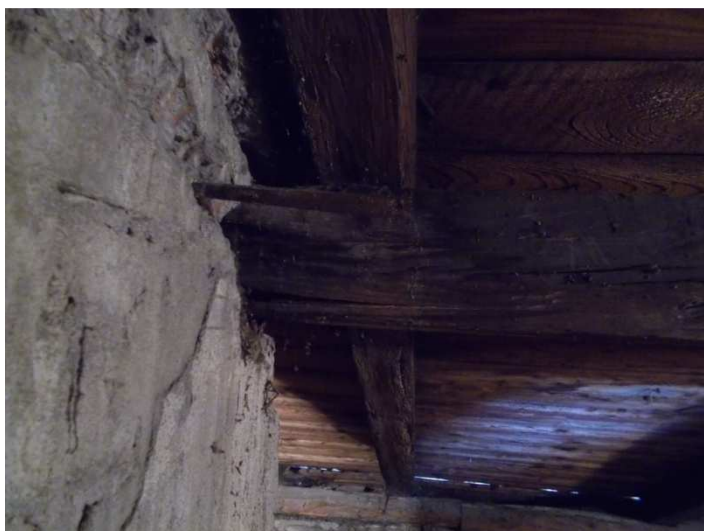
Příloha 19 Pultová střecha na jižní straně – poškozená vaznice
