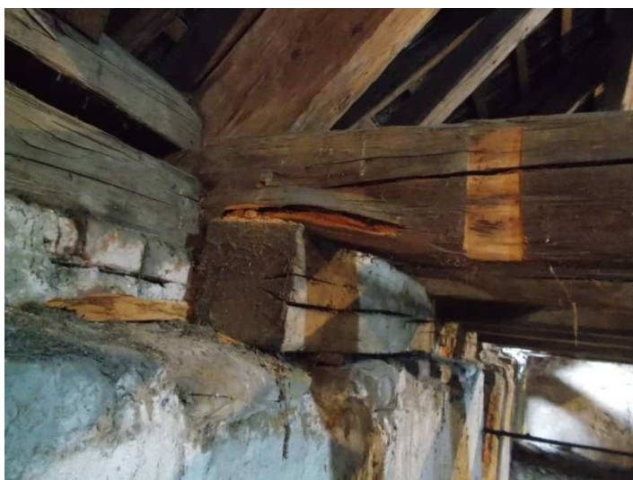
Příloha 5 Vazba 13, severní strana – znehodnocení vazného trámu
