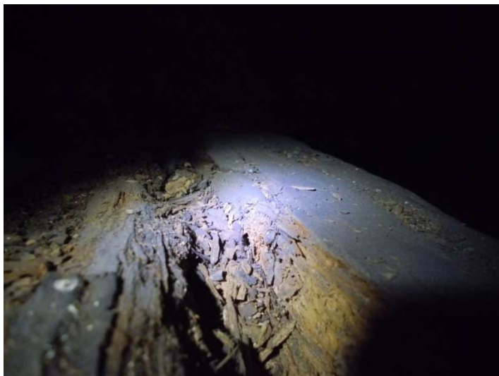
Příloha 15 Jižní věž – destrukce horního prahu na jižní straně
