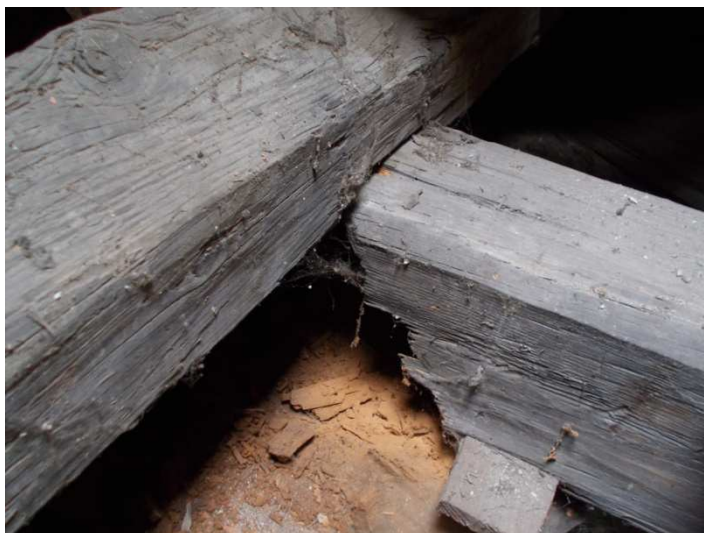
Příloha 11 Vazba 20, severní strana – destrukce vazného trámu
