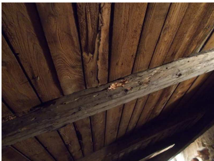
Příloha 16 Pultová střecha na jižní straně – krokev napadená tesaříkem
