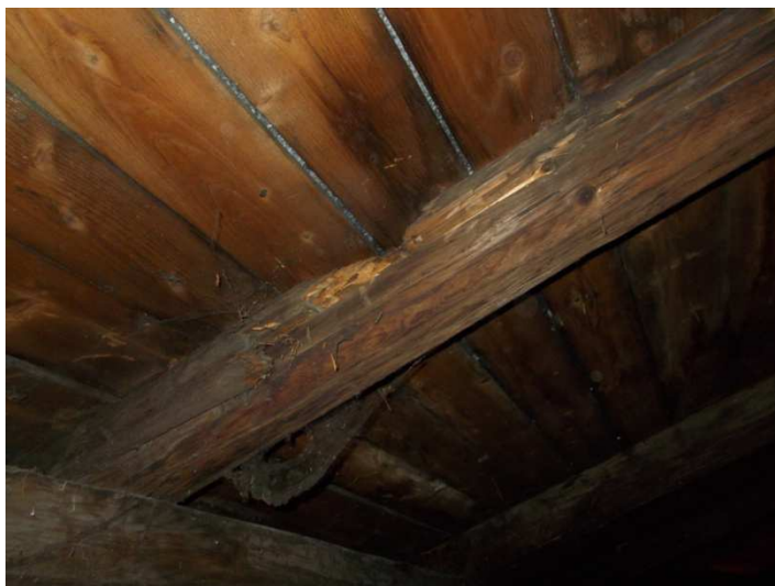
Příloha 17 Pultová střecha na jižní straně – krokev napadená tesaříkem
