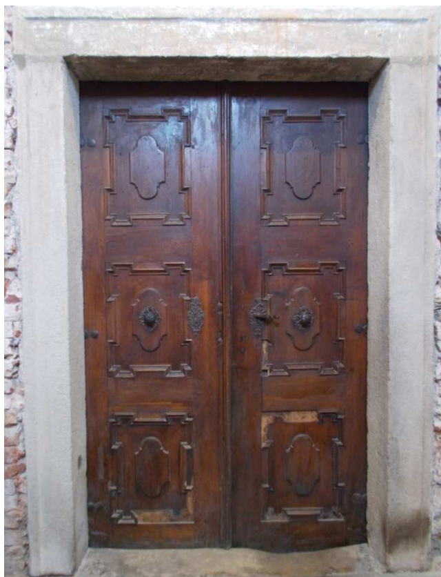
Příloha 22 Dveře do chrámové lodi kostela – chybějící prvky
