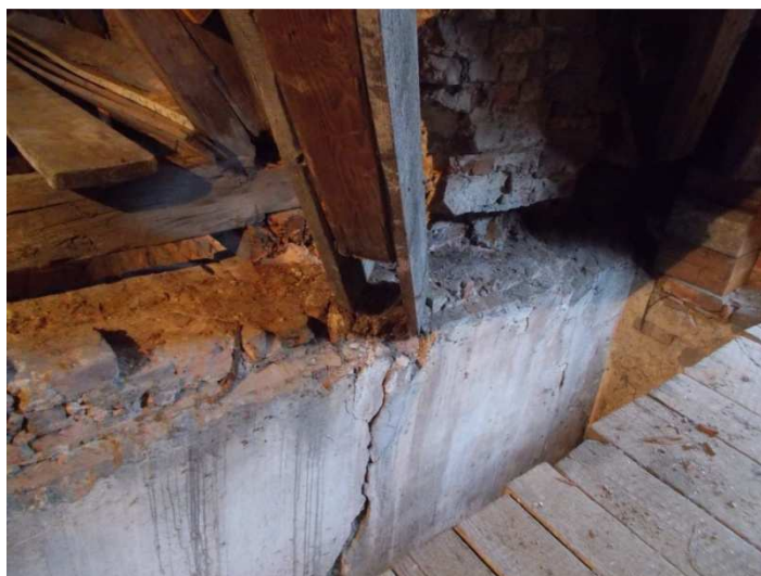
Příloha 7 Úžlabní krokev, jižní strana – nevhodná oprava
