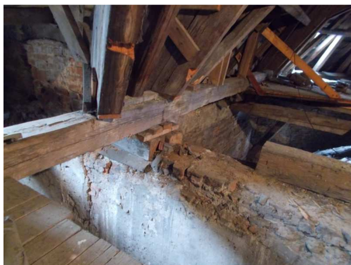
Příloha 9 Vazba 21, severní stana – chybí 1,5 m vazného trámu
