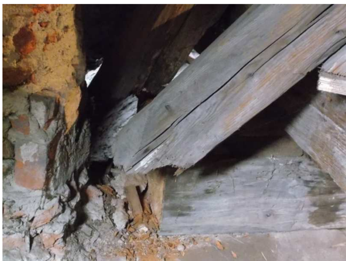
Příloha 10 Vazba 21, severní strana – destrukce krokve a napadení červotočem
