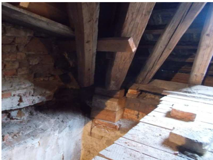
Příloha 8 Nárožní krokev, jižní strana – nevhodná oprava
