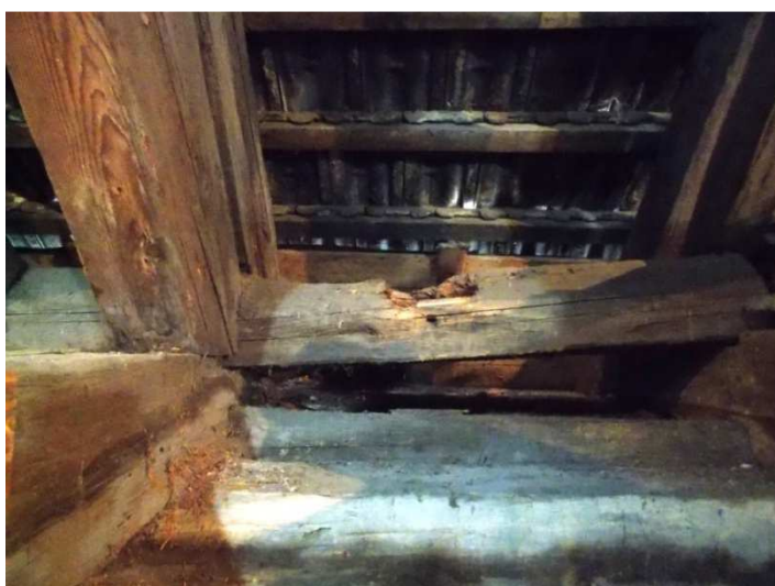
Příloha 6 Poškozený pětiboký práh, severní strana – mezi vazbou 13 a 14
