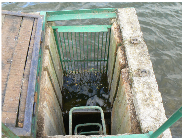
Obrázek č. 4.12 – Pohled na výpustní objekt požeráku na MVN Koloděje s osazeným vodočtem (VD TBD).
