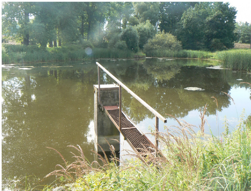
Obrázek č. 4.9 – Pohled na výpustní objekt požeráku na MVN Koloděje (VD TBD)
