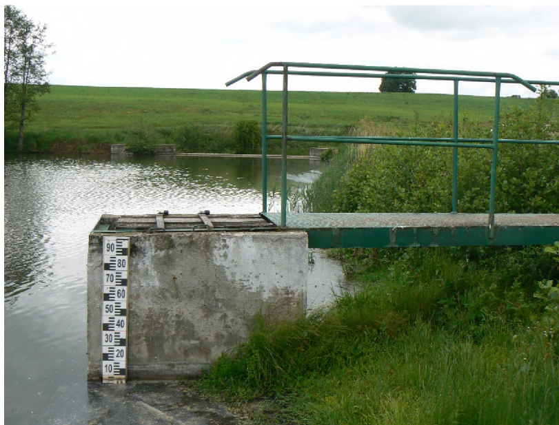
Obrázek č. 4.11 – Pohled na výpustní objekt požeráku na MVN Koloděje s osazeným vodočtem (VD TBD).
