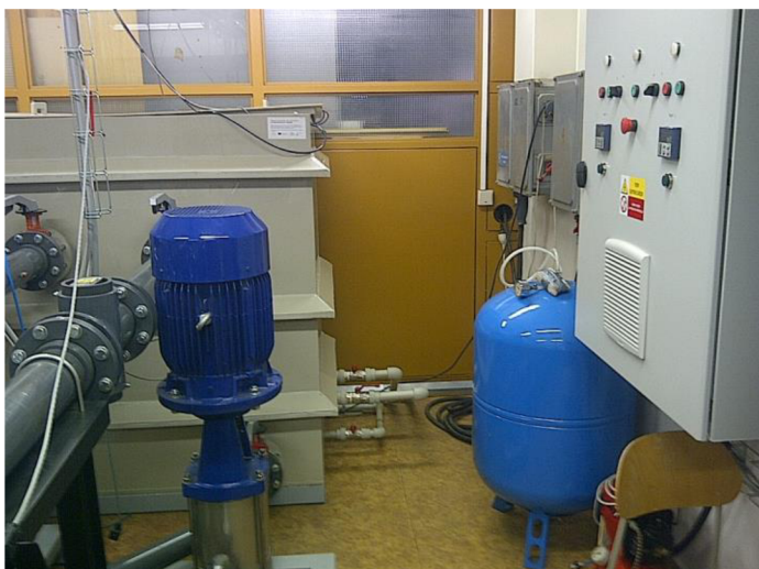
Obrázek 2: Ovládací panel motoru čerpadla, nádrž vody a čerpadlo
