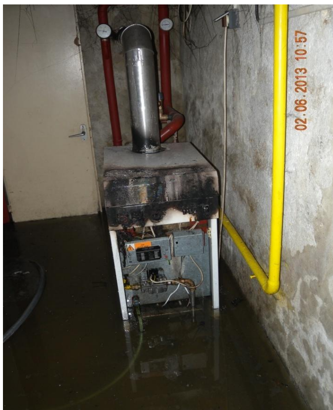
Fotografie č. 7, pohled do zatopené kotelny rodinného domu a následky požáru elektroinstalace spotřebiče na pevná paliva, autor fotografie Martin Petrák, archiv HZS JČK
