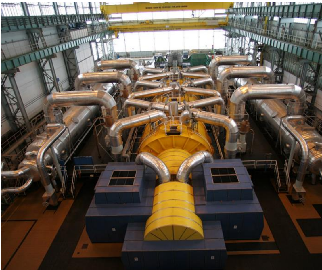
Obr. 3.8 Parní turbína v jaderné elektrárně Temelín. [34]
