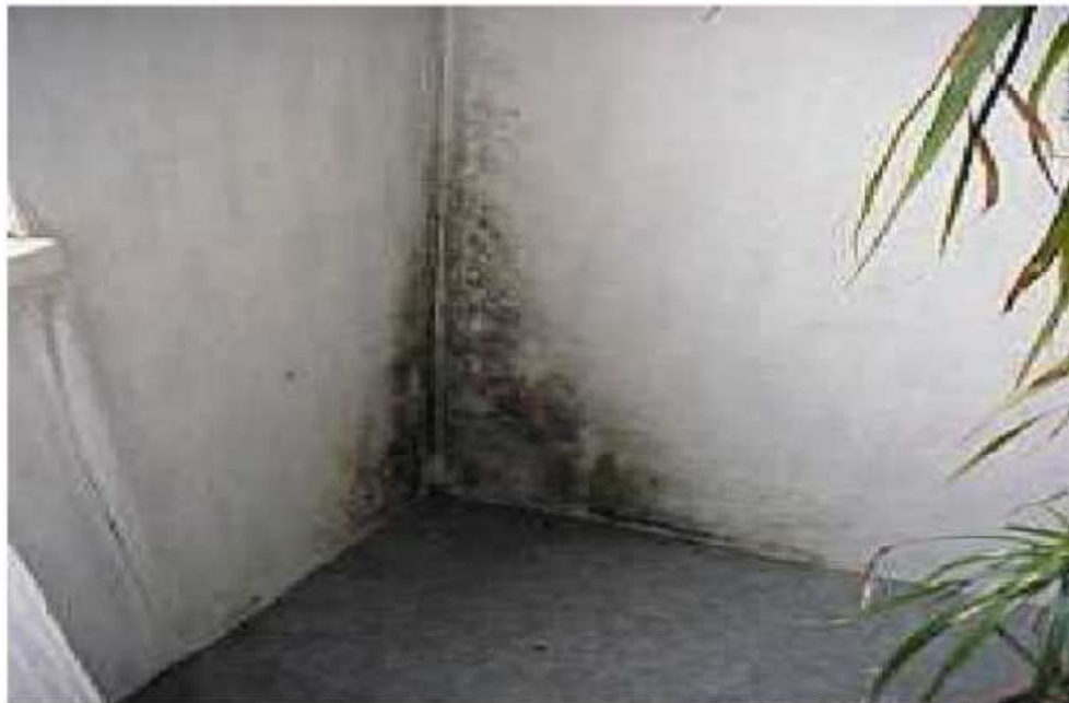
Obr. 1.4.2 Plíseň v rohu místnosti u podlahy na terénu v důsledku zanedbání posouzení trojrozměrného teplotního pole. [2 str. 7]
