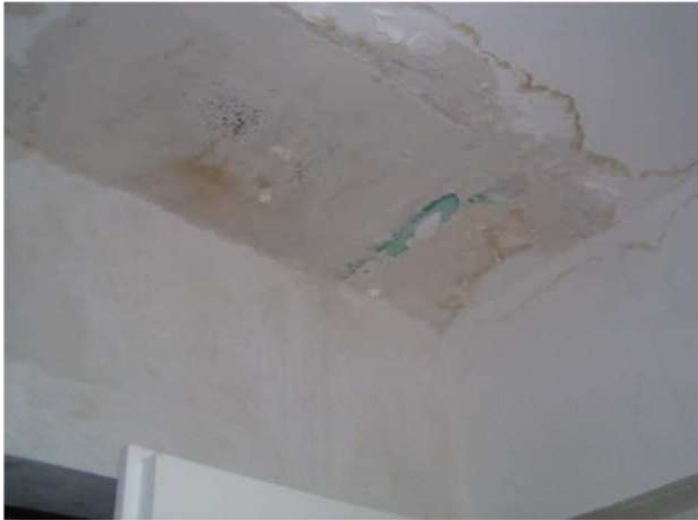
Obr. 1.4.1 Ukázka povrchové kondenzace vodní páry na stropě pod nevytápěným prostorem. Nosné prvky zde tvoří ocelové I profily, mezi nimi je minerální plst'. Tepelný most tvoří nezateplený I profil. [2 str. 7]
