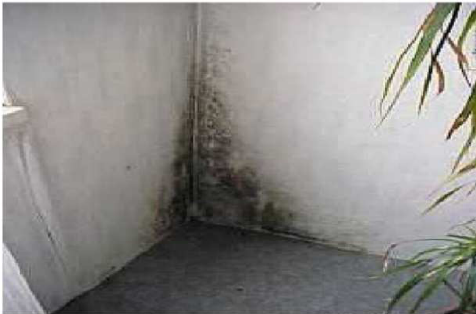
Obr. 1.4.2 Plíseň v rohu místnosti u podlahy na terénu v důsledku zanedbání posouzení trojrozměrného teplotního pole. [2 str. 7]
