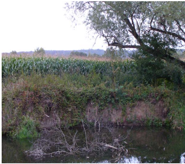
Foto 6: Nestabilizovaná břehová nátrž
