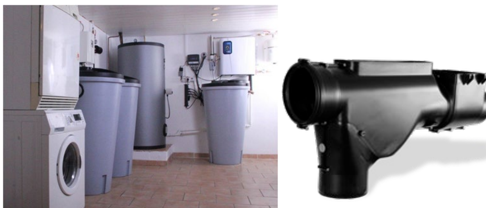
Obr. 5.3 Celá technologie na úpravu šedé a dešťové vody včetně zásobníku teplé užitkové vody (vlevo) a Filtr dešťové vody AS-PURAIN (vpravo) [53]
