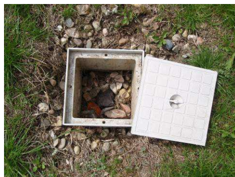
Obr. 36: Zanesená kontrolní šachta (vlastní foto, 21.4.2010)
