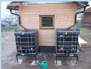
Obr. 29: Přepouštění dešťové vody
