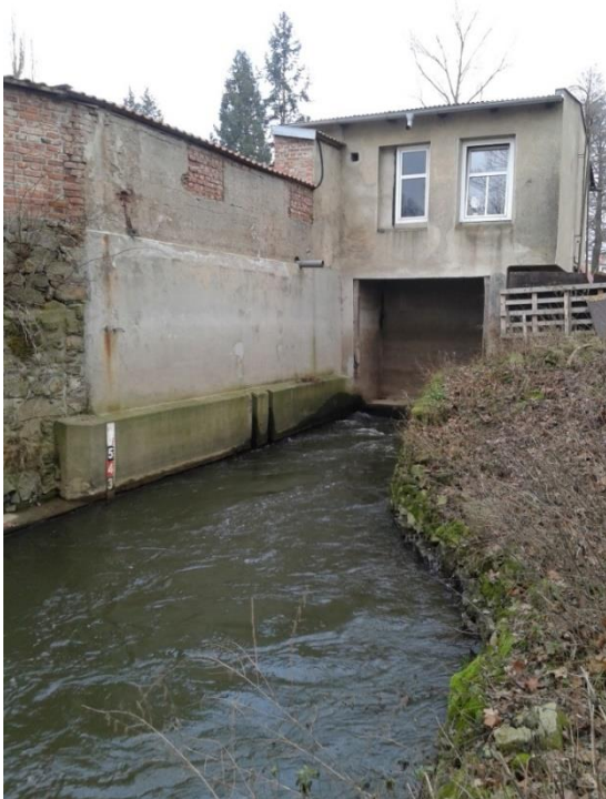
Obr. 4.11 Foto výusti MVE Perknov [vlastní zdroj]
