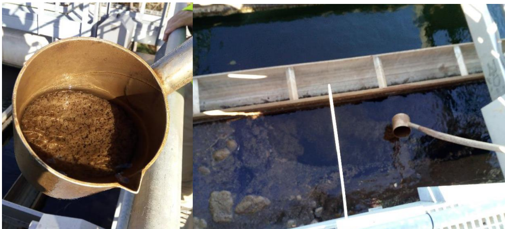
Obr. 10: Vzorek usazeného kalu a dosazovací nádrž (zdroj: vlastní, 2019)
