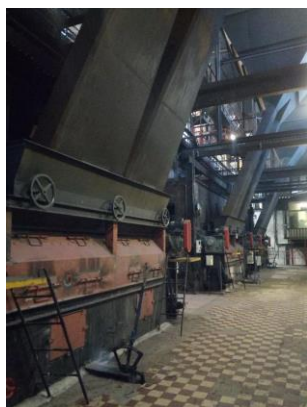
Obr.7: Kotelna, zdroj vlastní
