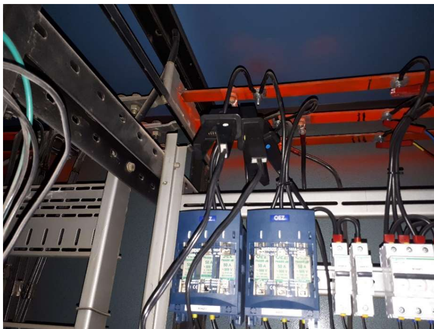
obr. 3: Osazení klešťových měřáků na přívod pro regeneraci
