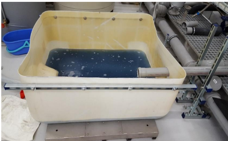
obr. 5–3: Nádrž na vypustenie odpadovej vody z práčky
