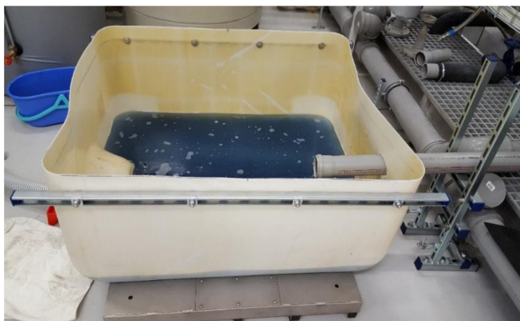
obr. 5–3: Nádrž na vypustenie odpadovej vody z práčky
