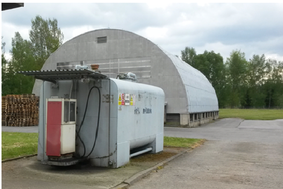
Obr. č. 9 – Nedostatečně zabezpečená NČS PHM (foto: autor)
