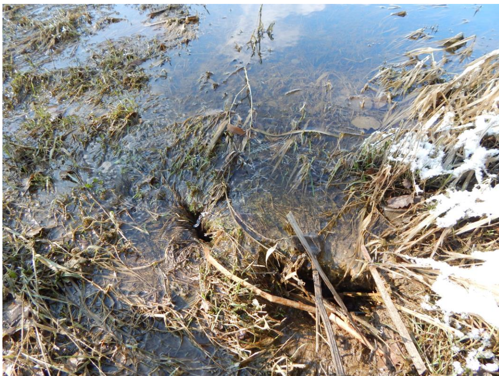
- Praskliny v bezpečnostním přelivu, 2016
