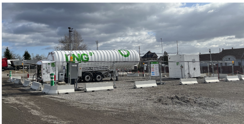
Obrázek 3.5: Mobilní LNG stanice
