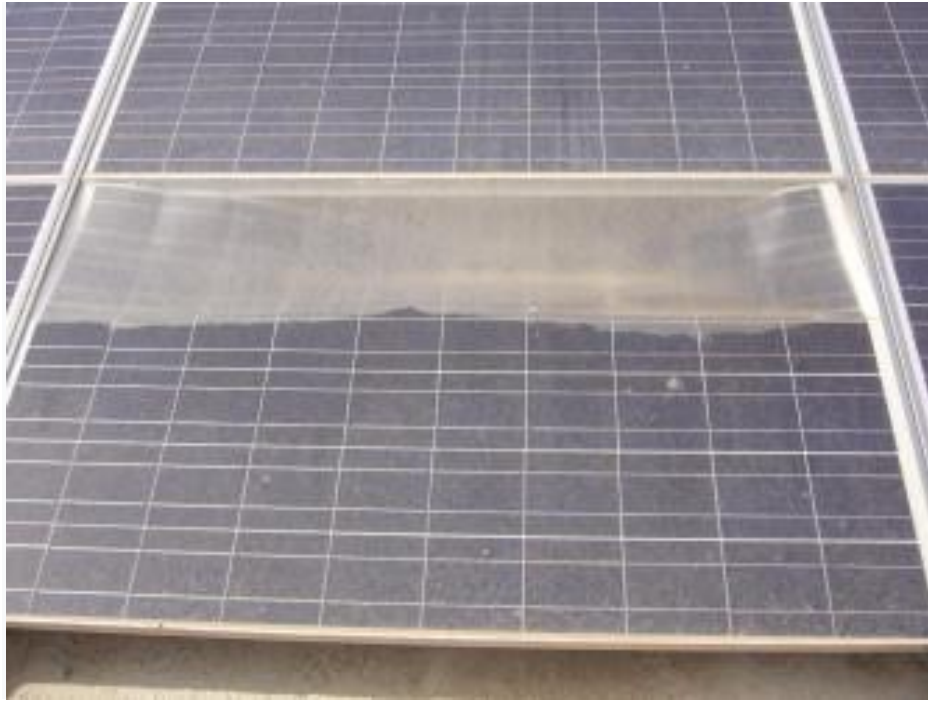
Obrázok 1. 9 – Poškodený panel vplyvom nekvalitnej inštalácie/spracovania[12]
