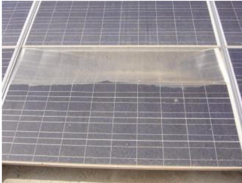
Obrázok 1. 9 – Poškodený panel vplyvom nekvalitnej inštalácie/spracovania[12]
