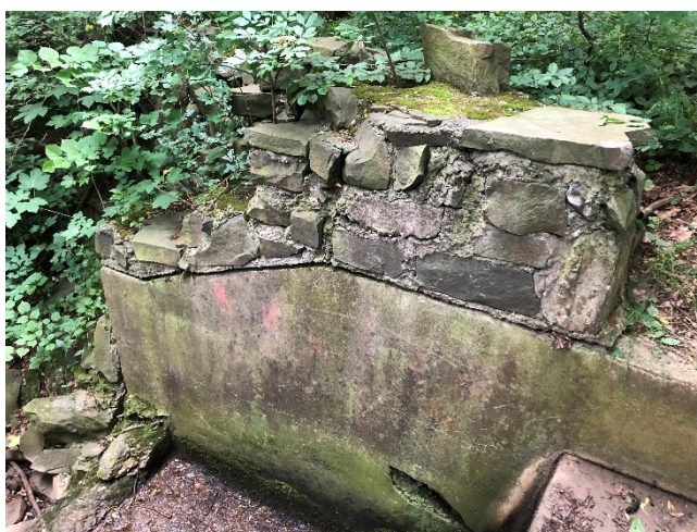
Obr. 22 Poškozené kamenné opevnění (Majkus, VI/2021)
