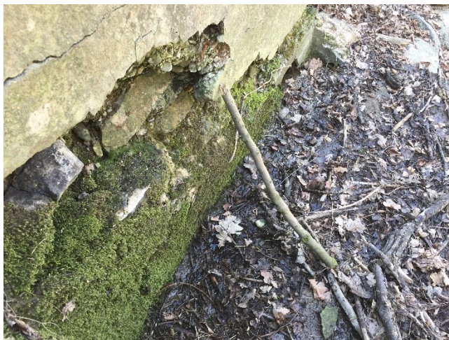
Obr. 23 Poškozený beton stupně (Trtílková, IV/2020) [22]
