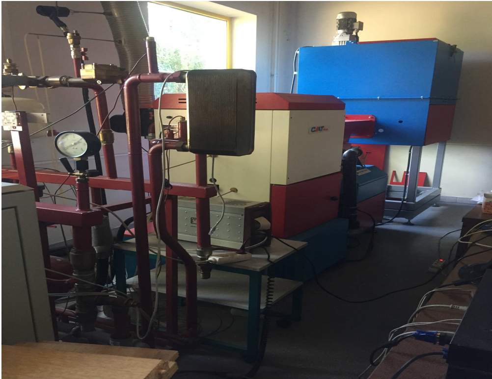
Obrázek č. 20: Celkový pohled na kotelnu (vlastní fotografie, 2017)
