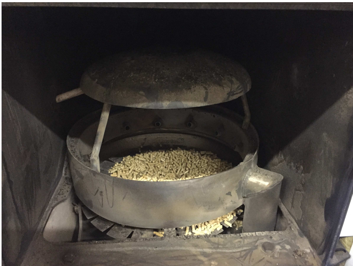
Obrázek č. 22: Příprava kotle před samovznícením na primárním hořáku (vlastní fotografie, 2017)
