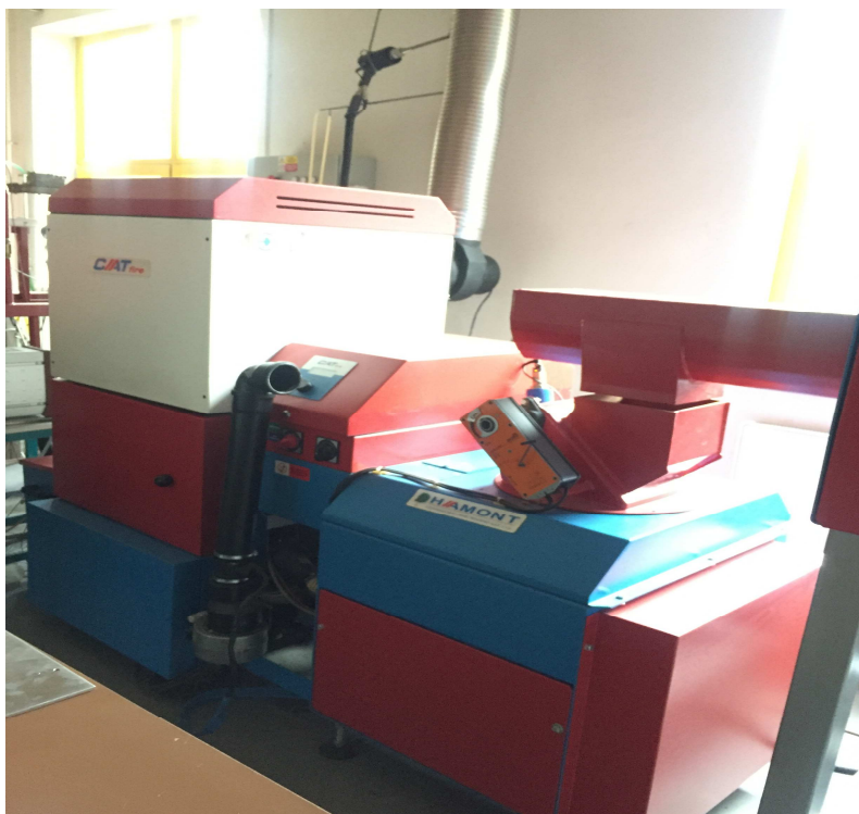
Obrázek č. 19: Celkový pohled na kotelnu (Fajman, 2013)
