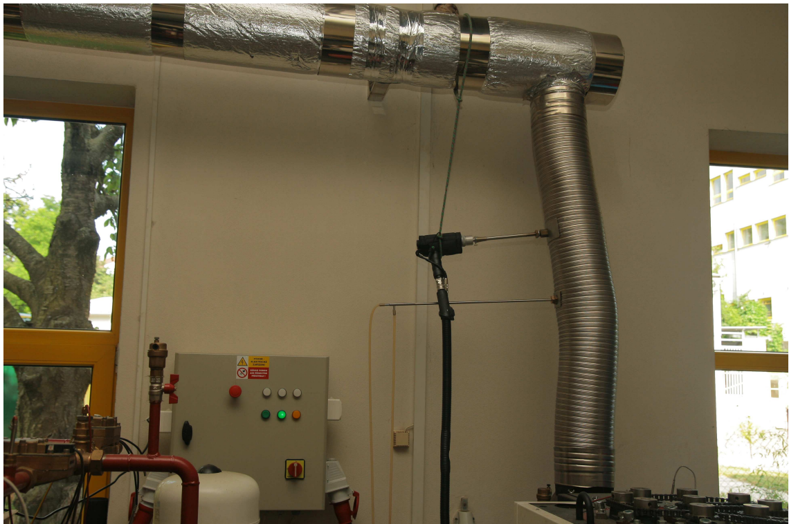
Obrázek č. 24: Odběrová sonda emisního analyzátoru v komínové části, vlevo rozvaděč s bezpečnostním vypnutím (Fajman)
