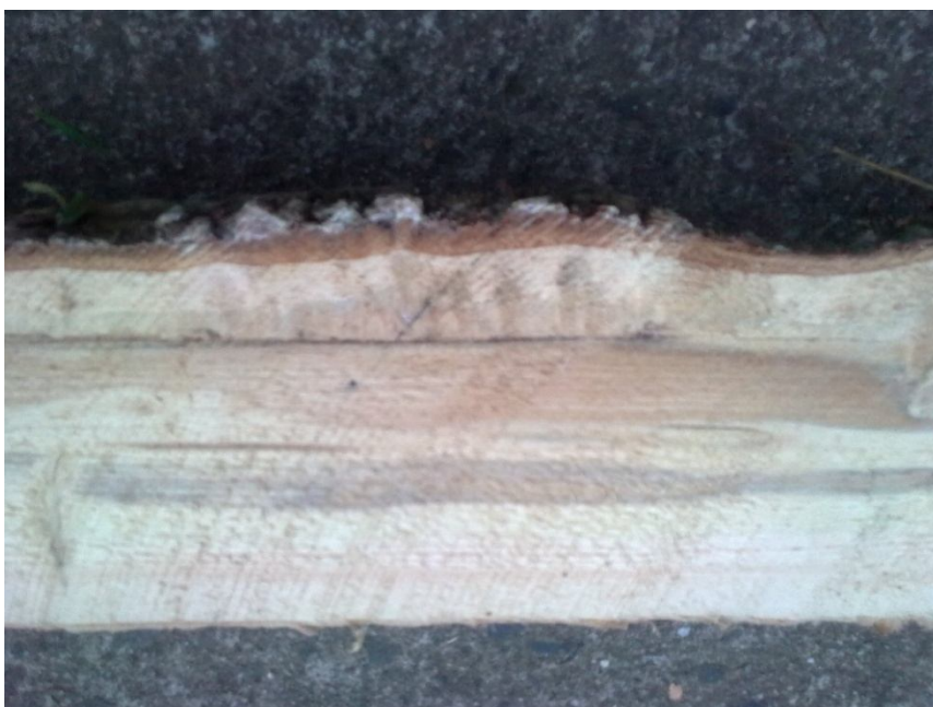
Obrázek č. 8 - Podélný řez hnilobou poškozené dřevní hmoty, Záhořík 2011
