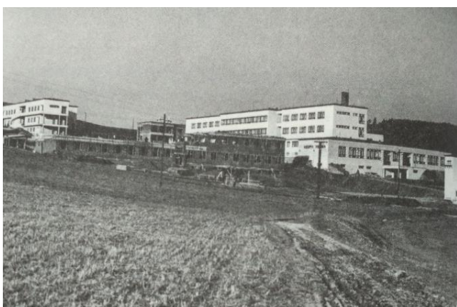
Obr. č. 9 : Stavba nemocnice Zdroj: KŘESADLO, Vít – KRUŽÍK, Miroslav Historický kalendář NMNM na léta 1945-1990 , str. 315.
