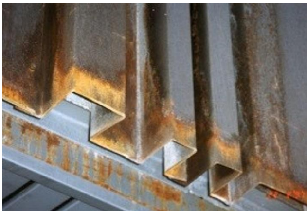
Obrázek 1 Ilustrace koroze 1. Dostupné z (Asociace korozních inženýrů, z.s., 2012)
