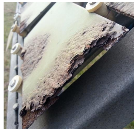
Obrázek 2 Ilustrace koroze 2. Dostupné z (Asociace korozních inženýrů, z.s., 2012)
