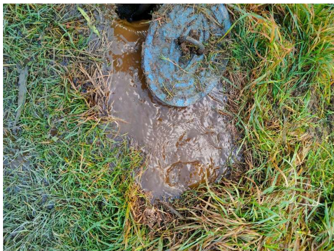
Obrázek 19. Odkalování hydrantu Kamenec
