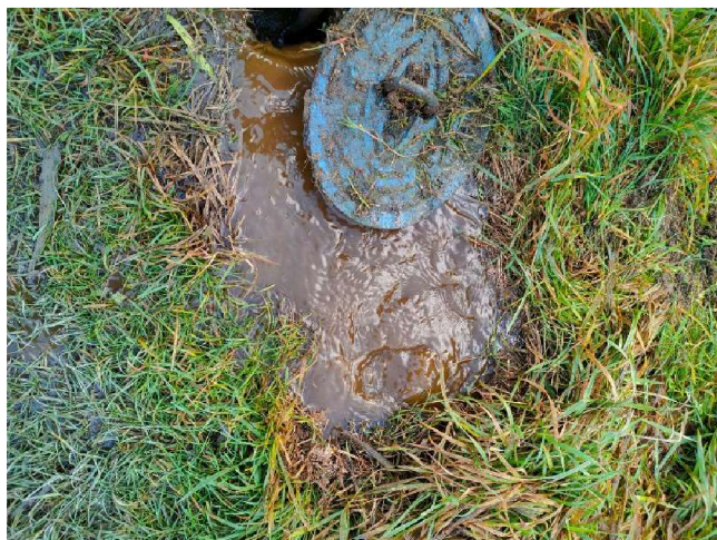
Obrázek 19. Odkalování hydrantu Kamenec
