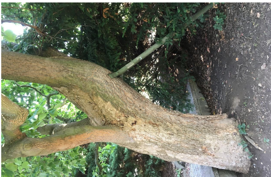
Příloha č. 20 – Lokalita č. 2 – liliovník tulipánokvětý ( Liriodendron tulipifera ) – p. č. 30, nakloněný jedinec, stabilizovaný podpěrou
