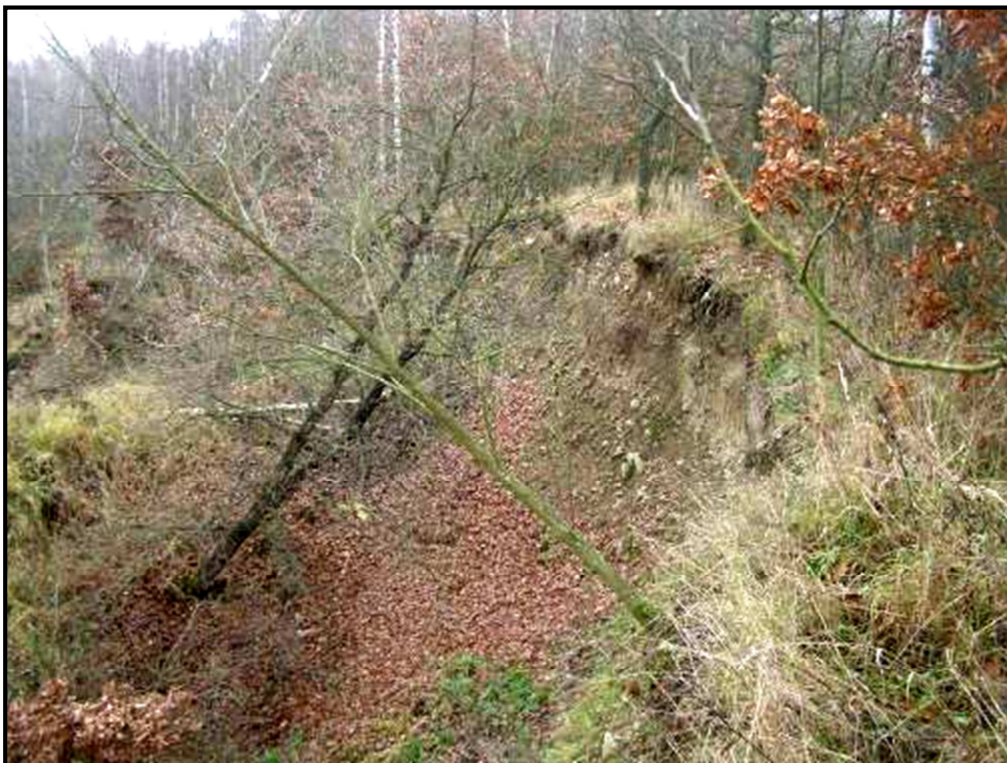
Obrázek 7: Současný stav svahů nad severní stranou Barbory (foto autor)
