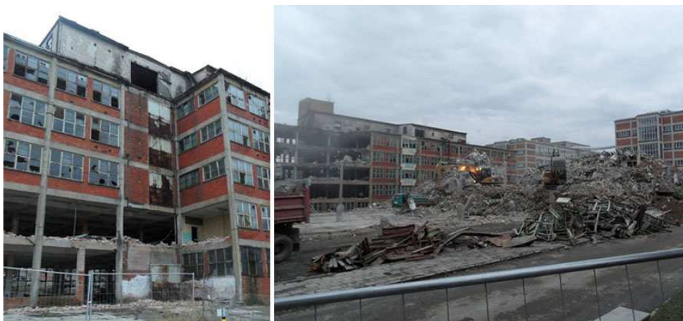
Obr.X : Demolice budov číslo 24-26 v bývalé továrně Tomáše Bati ve Zlíně. Zdroj : archiv David Korala, Zlínský deník.
