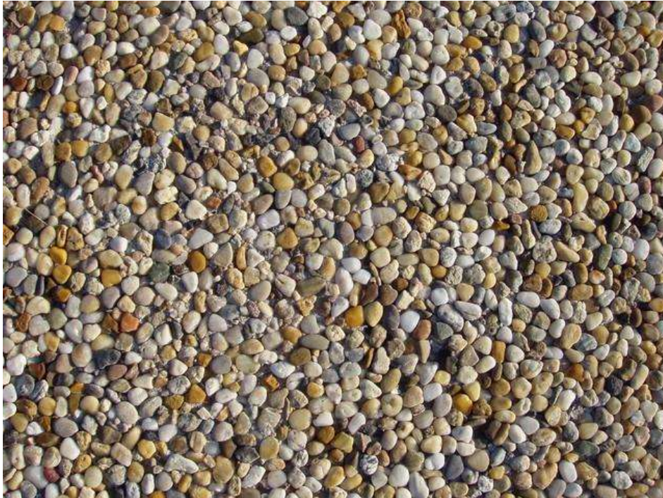
Obr. 8 Vymývaný betonový povrch
