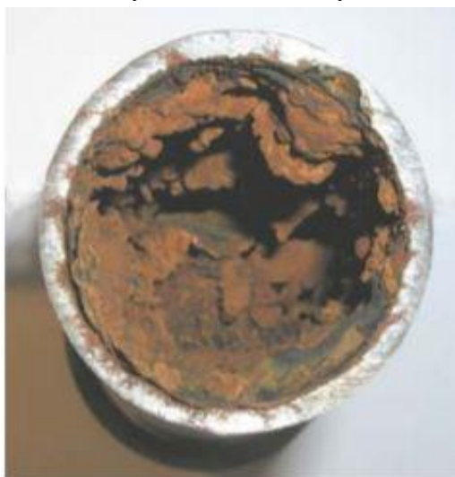
Obr. 16 Koroze uhlíkové oceli v pitné vodě [36]
