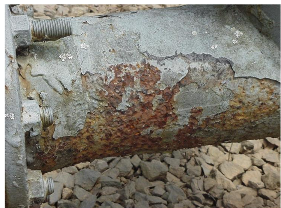
Obr. 15 Atmosférická koroze potrubí [38]
