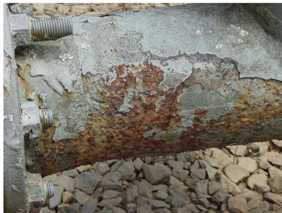
Obr. 15 Atmosférická koroze potrubí [38]
