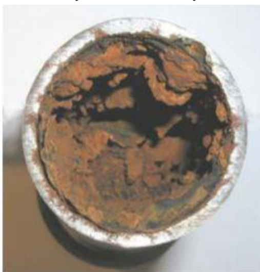
Obr. 16 Koroze uhlíkové oceli v pitné vodě [36]
