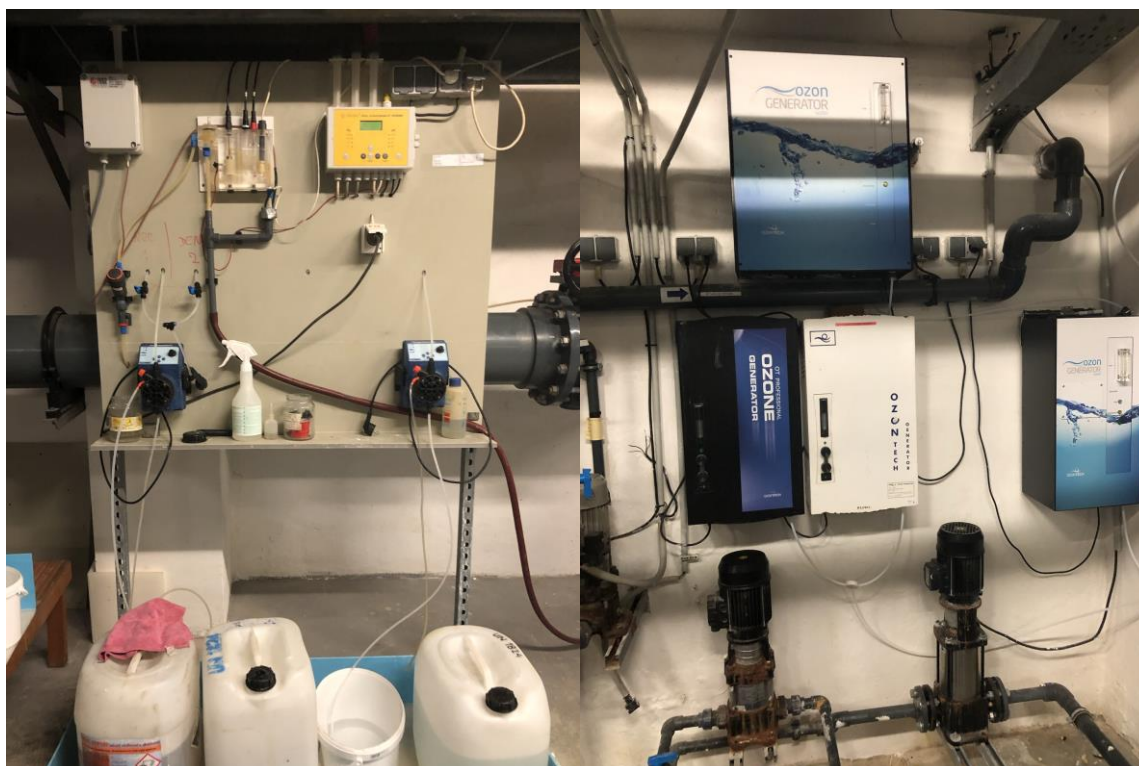
Obr. 4.7 Měřící a regulační jednotka s dávkovacími čerpadly (vlevo) a ozonizace (vpravo)
