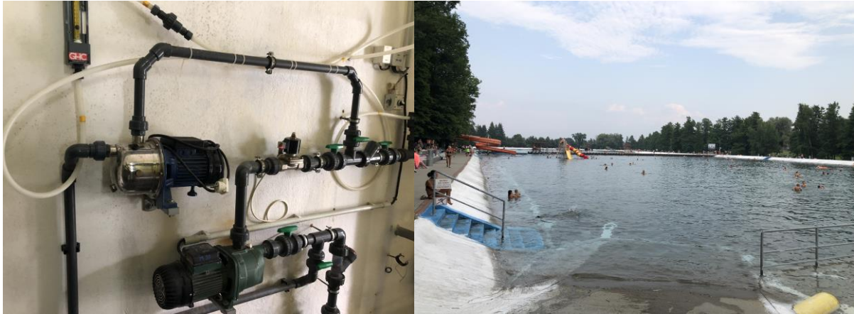
Obr. 4.9 Dávkovací čerpadlo plynného chloru (vlevo) a pohled na malý neplavecký bazén (vpravo)
