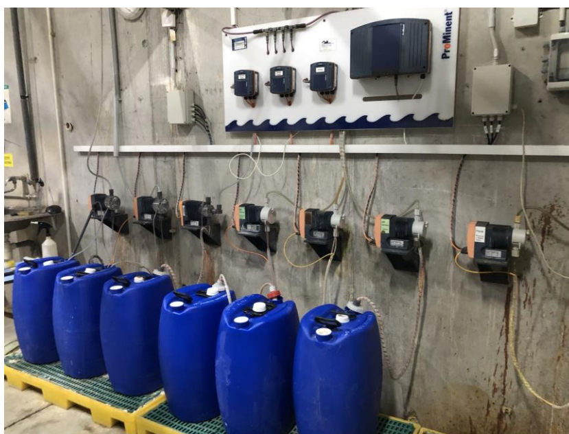
Obr. 4.29 Měřící a řídicí stanice s dávkovacími čerpadly a barely chemikálií
