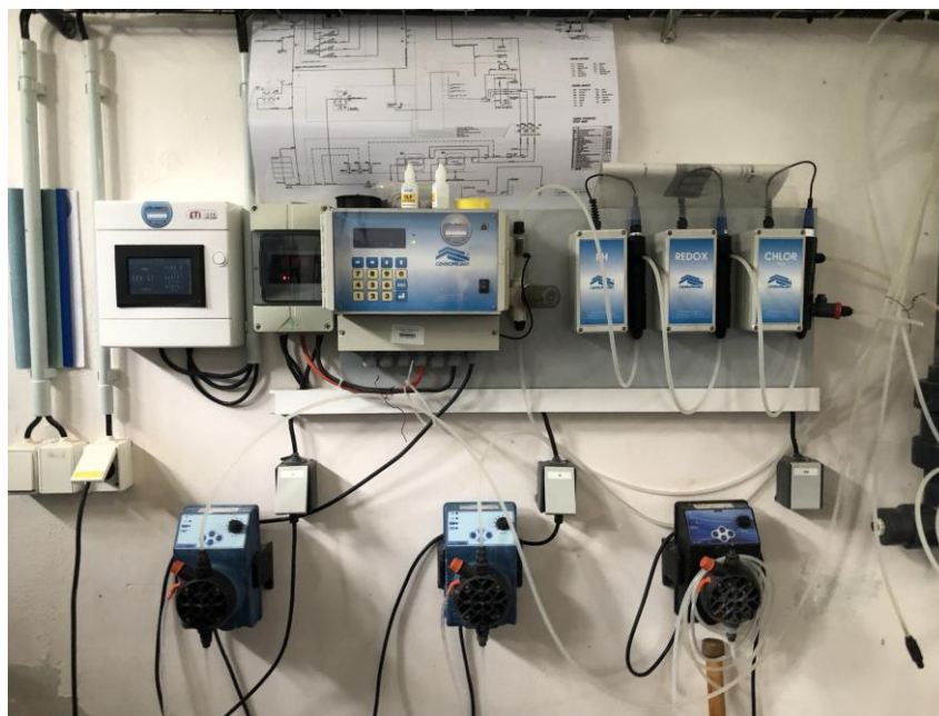
Obr. 4.13 MaR jednotka a s dávkováním dezinfekčních činidel a korektorů pH v malé úpravně vody
