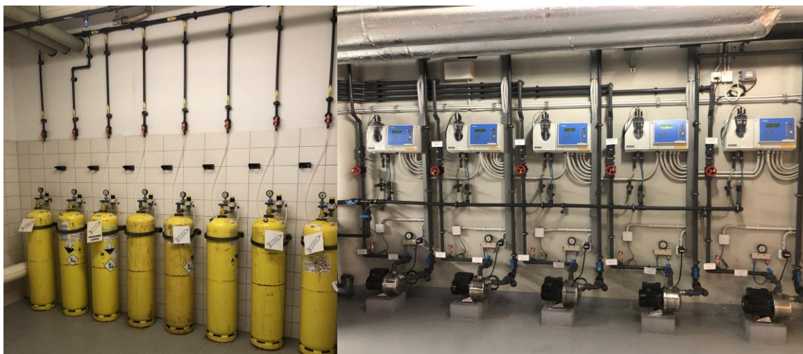
Obr. 4.26 Provozní sklad plynného chloru (vlevo) a dávkování chloru (vpravo)
