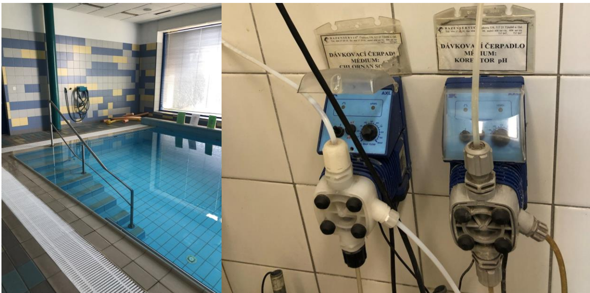
Obr. 4.17 Rehabilitační bazén (vlevo) a detail dávkování chemikálií (vpravo)
