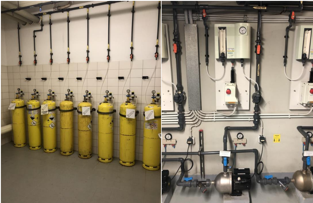
Obr. 3.3 Provozní sklad plynného chloru (vlevo) a dávkování plynného chloru (vpravo) [foto autor]
