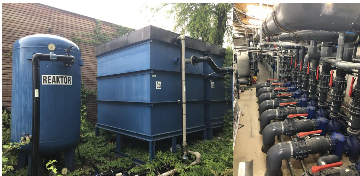
Obr. 4.3 Reaktor a čířiče (vlevo) a pohled do velké technické místnosti (vpravo)
