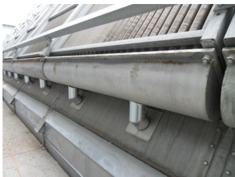
Obr. 3.8 Kondenzátor SAKO Brno – sběrač kondenzátu se zaizolovanými vývody
