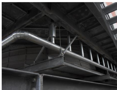
Obr. 3.9 Kondenzátor SAKO Brno – odvod kondenzátu do kondenzátní nádrže
