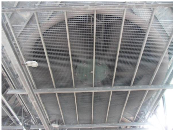
Obr. 3.11 Kondenzátor SAKO Brno – axiální ventilátor
