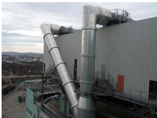
Obr. 5.4 Dvě větve potrubí DN 1700
