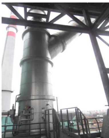
Obr. 3.10 Kondenzátor SAKO Brno – přívod páry do kondenzátoru (DN 2200)
