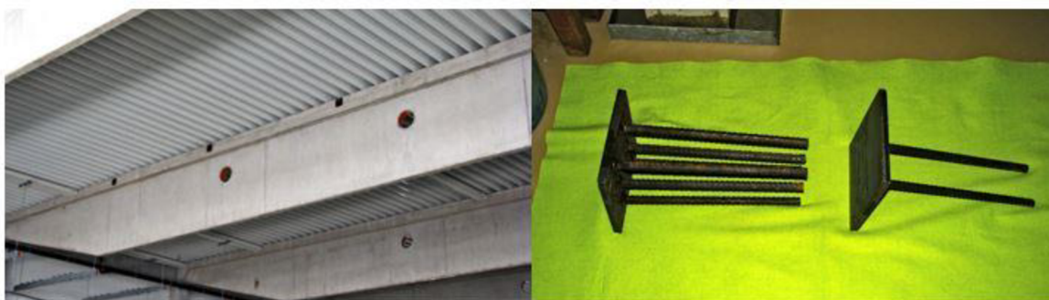
Obrázek 24 – Kontrola počtu kotevních trnů na kotevních deskách
