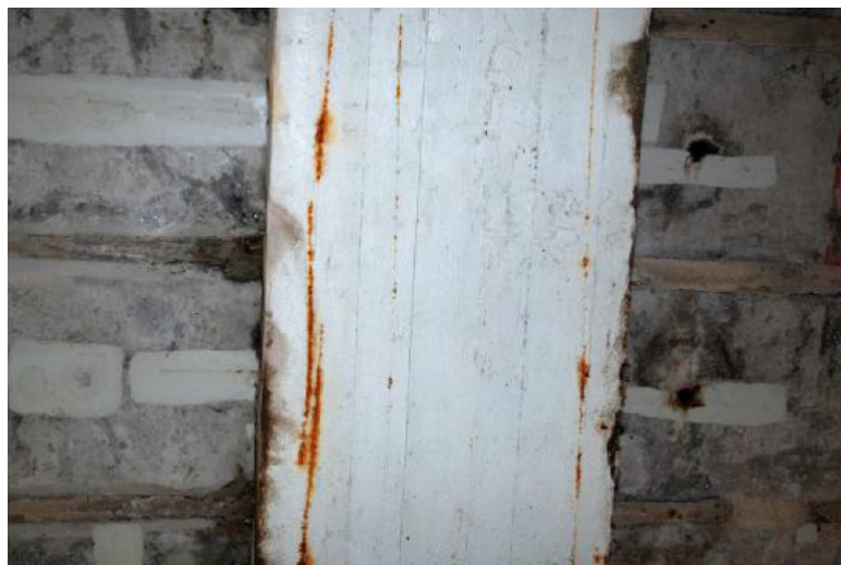
Obrázek 3.4: Odvodňovacie otvory prekryté sanačným náterom [11]
