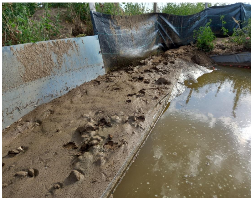
Obr. 35 – spodní hrana jímky č. 1 před vyčištěním (vlastní foto 7/2023)
