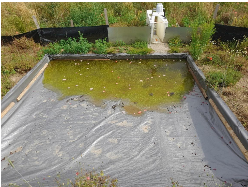
Obr. 32 - sedimentační jímka č. 3 před vyčištěním (vlastní foto 7/2023)
