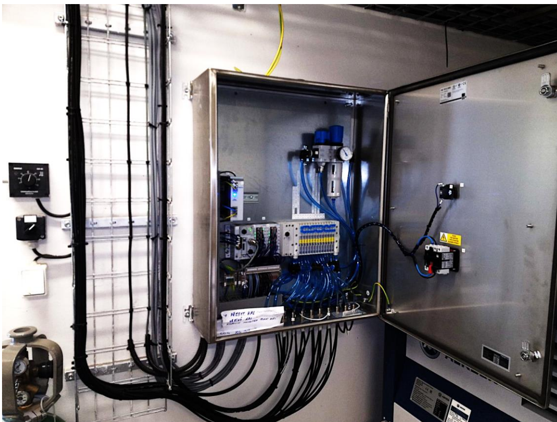
Obrázek 10 – Ventilový terminál s veškerým vybavením (ČOV Obříství)
