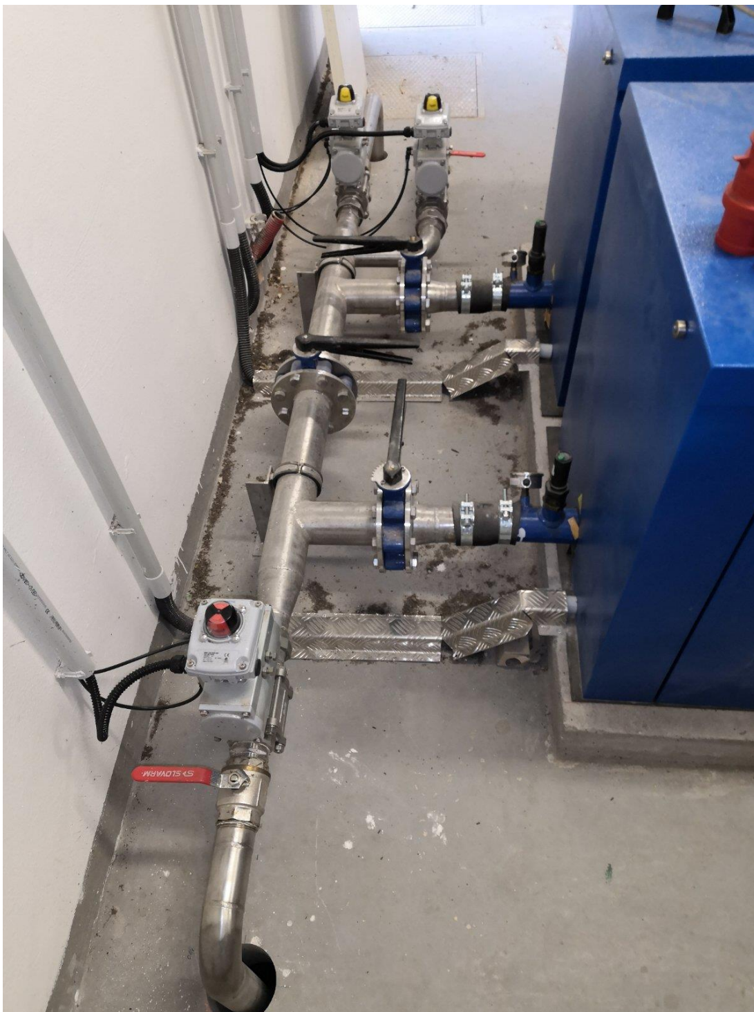
PŘÍLOHA Č. 4 – kulové kohouty s pneumatickými pohony (Y17, Y18, Y19) na rozvodech stlačeného vzduchu z dmychadel (ČOV Obříství)
