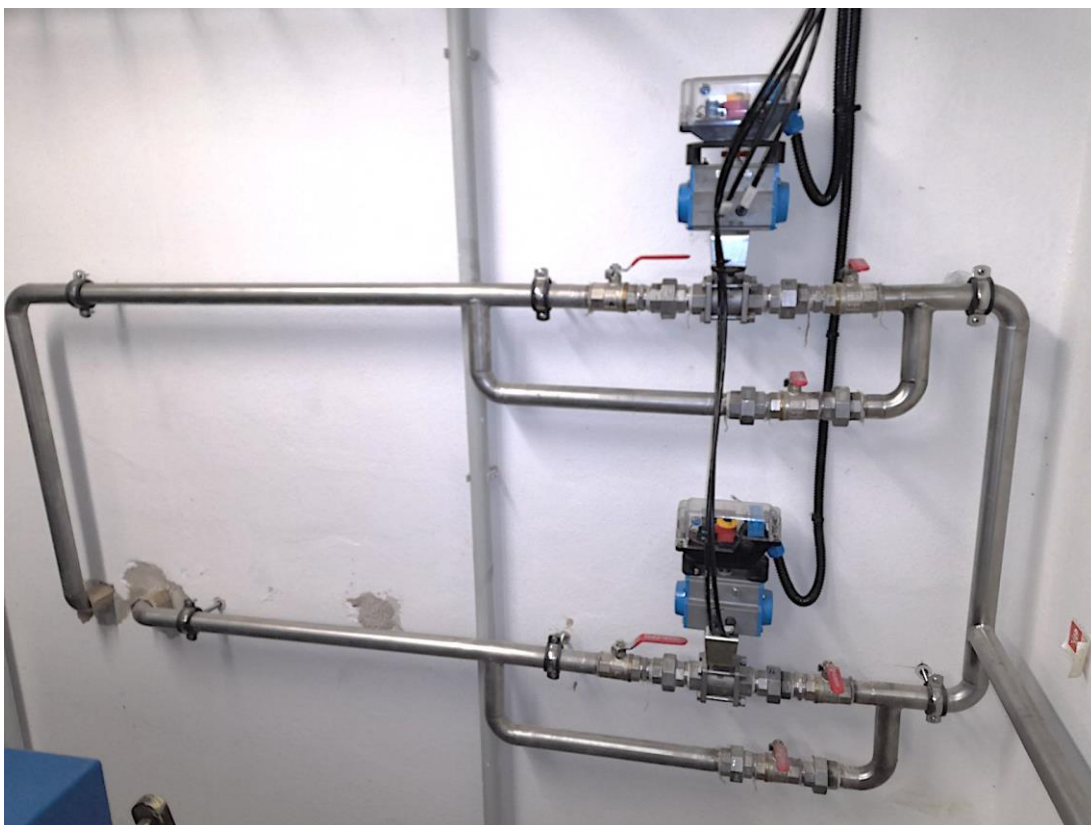
PŘÍLOHA Č. 5 – kulové kohouty s pneumatickými pohony (Y15, Y16) na potrubí stlačeného vzduchu pro provzdušnění lapáku písku (ČOV Obříství)
