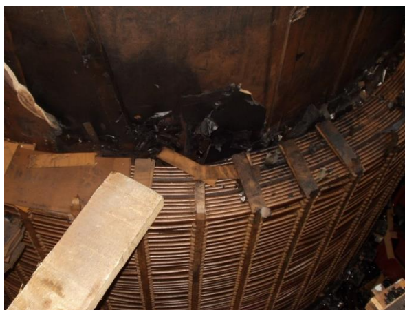
Obrázek 2.10 Poškození transformátoru vlivem částečných výbojů.
