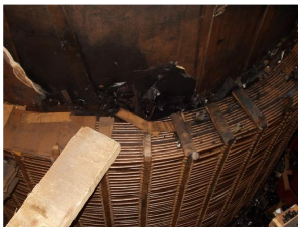
Obrázek 2.10 Poškození transformátoru vlivem částečných výbojů.
