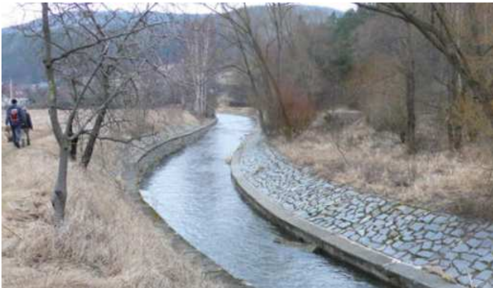
Obr. 9 Technicky upravené koryto – nevhodné zpevnění v místech extravilánu [28]
