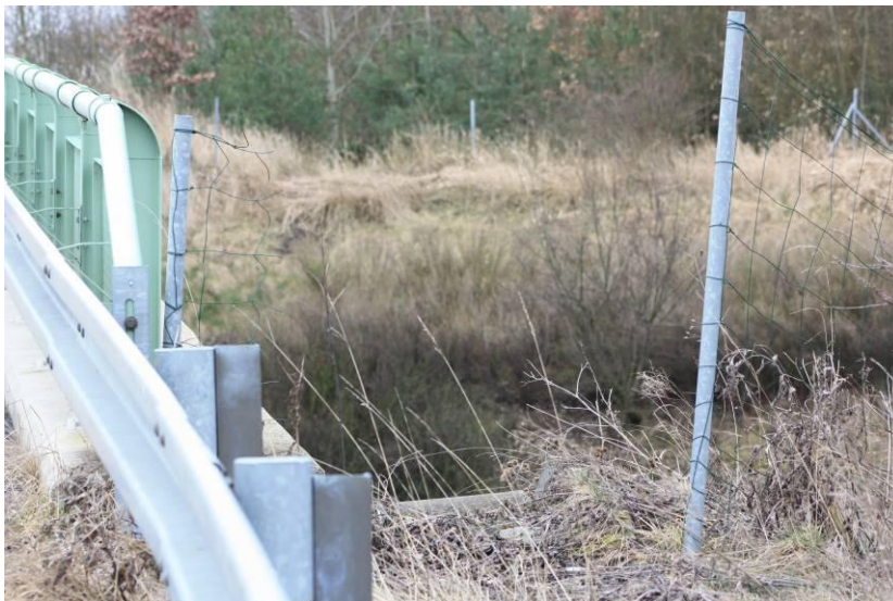
Obr.č.47: Fotografie poškozeného plocení u dálničního objektu (vlastní).
