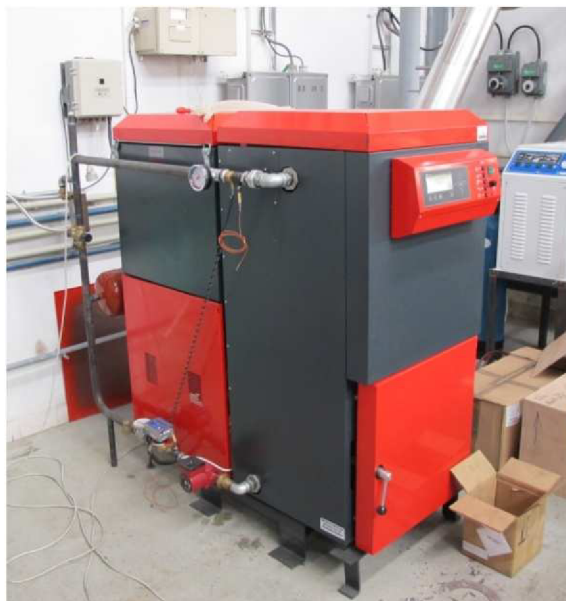
Obr. 31 Pohled na automatický teplovodní kotel Verner A251.1 umístěný v budově laboratoří
