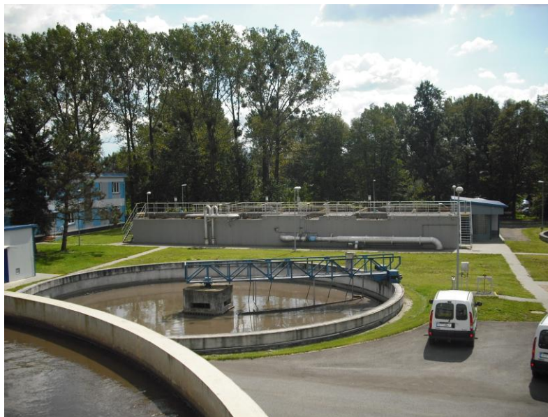
Obr. č. 3.3-15 ČOV Nový Jičín - usazovací nádrž, kaskádová aktivační nádrž [zdroj: Čížová]
