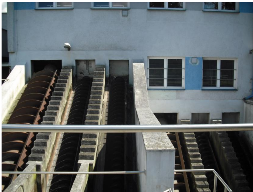
Obr. č. 3.3-13 ČOV Nový Jičín - šneková čerpací stanice [zdroj: Čížová]
