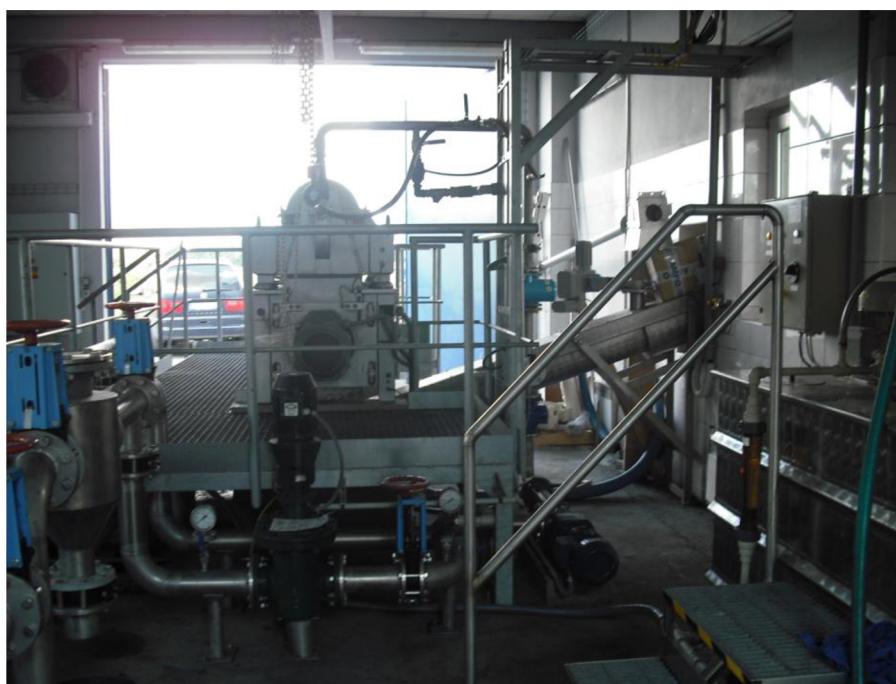
Obr. č. 3.3-20 ČOV Nový Jičín - odstředivka [zdroj: Čížová]
