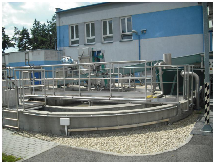
Obr. č. 3.3-14 ČOV Nový Jičín - lapák písku, strojně stírané česle [zdroj: Čížová]
