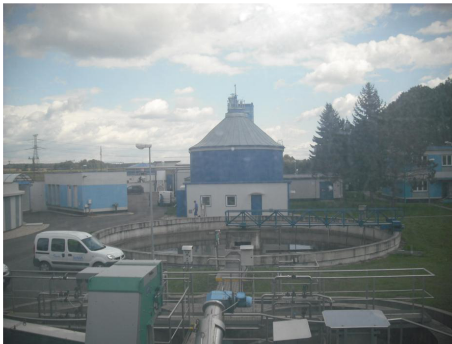
Obr. č. 3.3-19 ČOV Nový Jičín - vyhnívací a usazovací nádrž [zdroj: Čížová]
