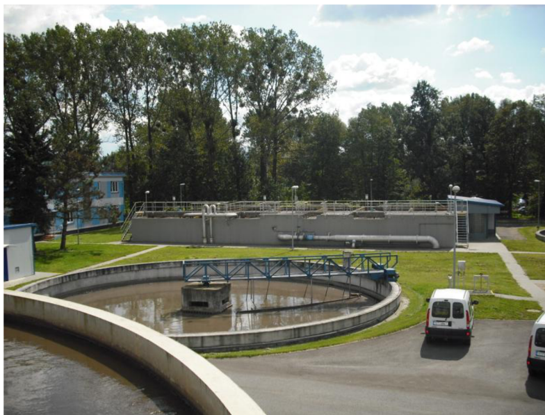
Obr. č. 3.3-15 ČOV Nový Jičín - usazovací nádrž, kaskádová aktivační nádrž [zdroj: Čížová]
