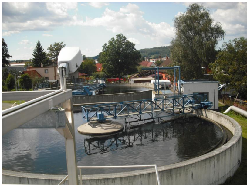
Obr. č. 3.3-18 ČOV Nový Jičín - dosazovací nádrže [zdroj: Čížová]
