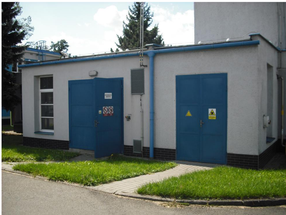
Obr. č. 3.3-21 ČOV Nový Jičín - budova kogenerační jednotky [zdroj: Čížová]
