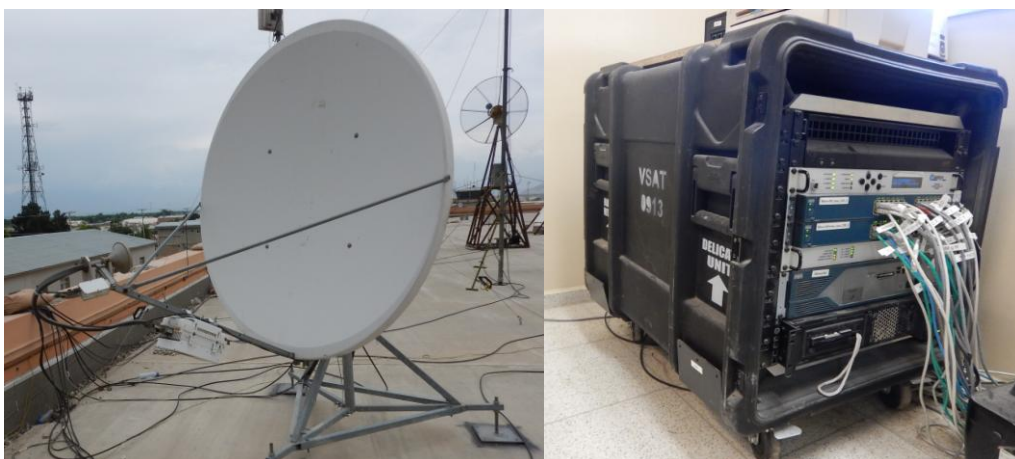
Obrázek 5.1 VSAT s technologickým modulem BLACKBOX [Zdroj: vlastní]
